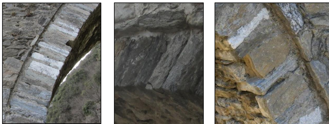
Εικόνα 31: Απώλειες τμημάτων λιθοσωμάτων τόξων και ρηγματώσεις.
