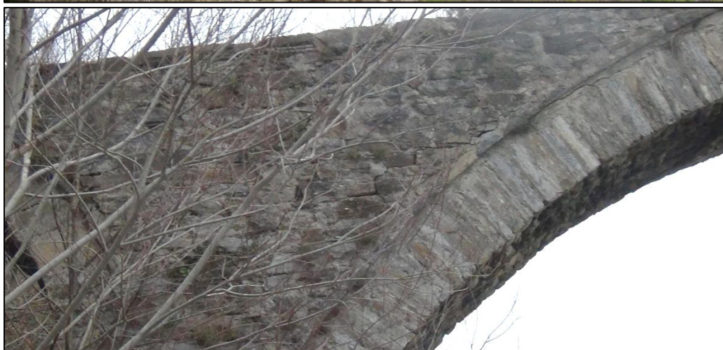
Εικόνα 21: Ρηγμάτωση τυμπάνου δυτικού ακροβάθρου: Διαδοχικά, το 2010, 2015 και 2022.
