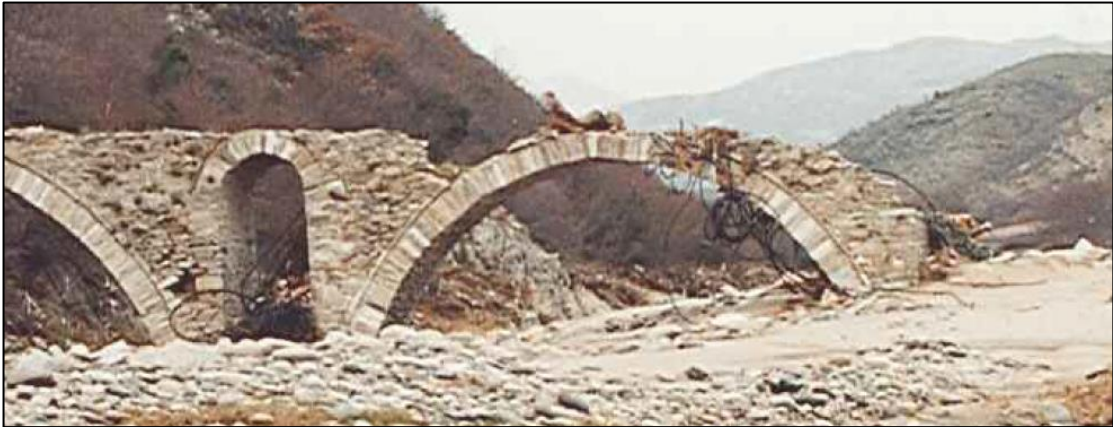
Εικόνα 3: Πλημμύρα 1996. Καταστροφή ανατολικού ανακουφιστικού ανοίγματος. Συσσώρευση φερτών υλικών στα ανοίγματα.
