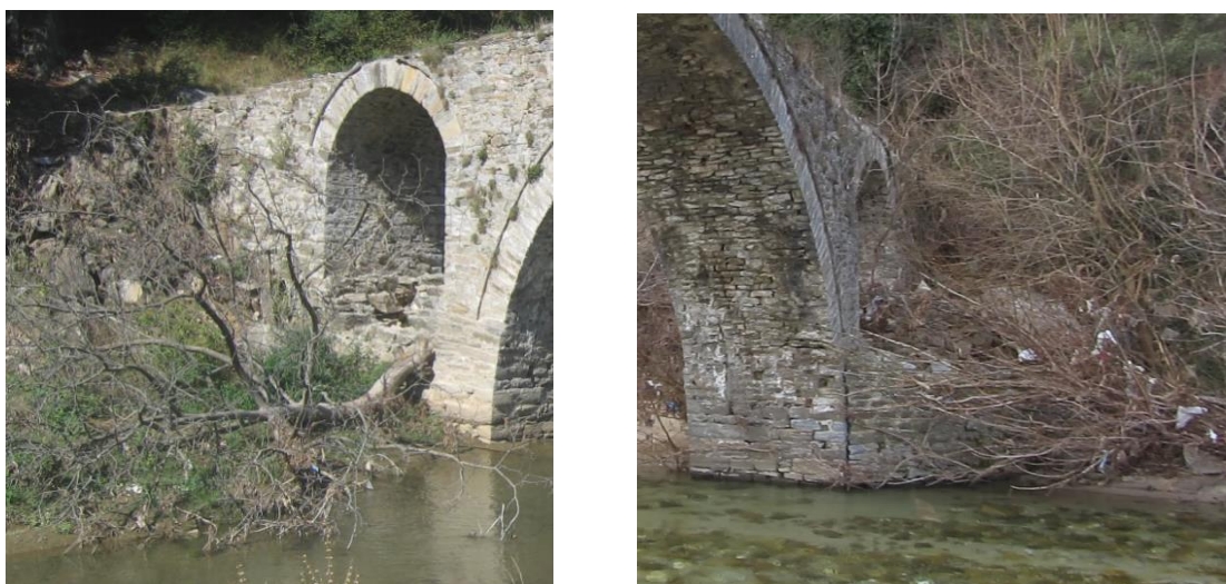
Εικόνα 23: Παρασυρόμενοι κορμοί δέντρων στην περιοχή του δυτικού ακροβάθρου.
