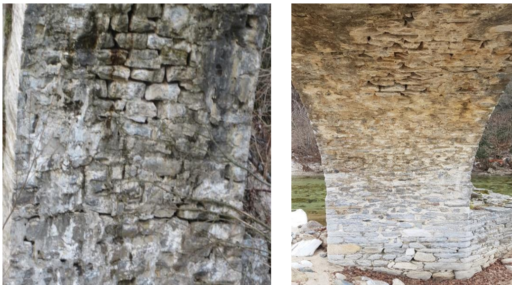
Εικόνα 25: Απώλεια ασβεστοκονιάματος στα εσωράχια των τόξων και στα βάθρα.
