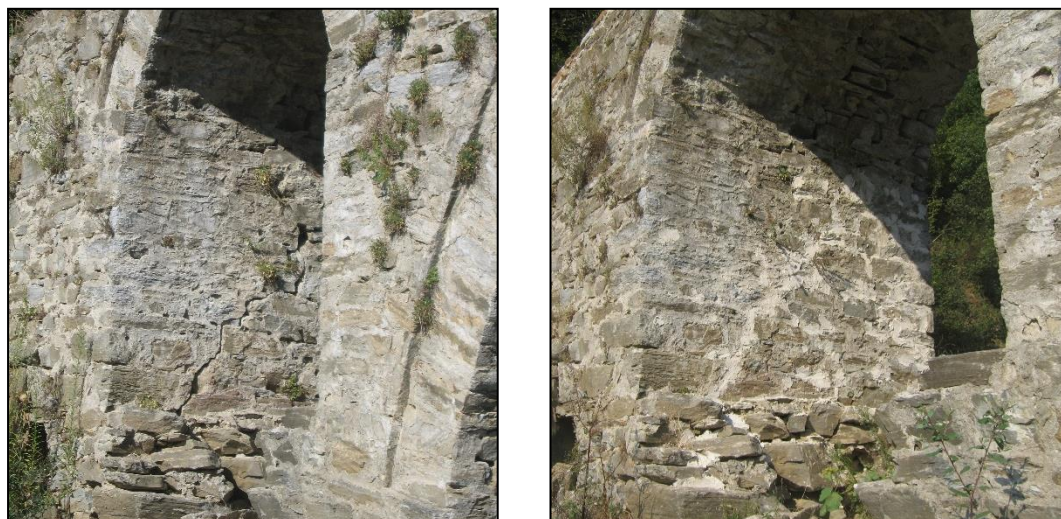
Εικόνα 22: Ρηγματώση εσωραχίου δυτικού ανακουφιστικού ανοίγματος προ και μετά επέμβασης.
