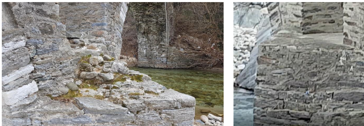
Εικόνα 28: Απώλεια λιθосωμάτων και επικάλυψης στέψης υδατοθραύστη. Αριστερά αντίστοιχη πλήρης μορφή υδατοθραύστη.
